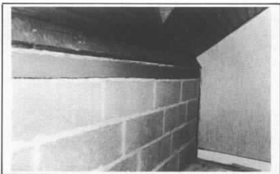
Le mur fini doit laisser apparaître les semelles élastomères sur ses quatre côtés : c'est une « condition impérative » ! Ici, malgré la faible hauteur, ce sont plus de 1 200 kg qui sont suspendus.
