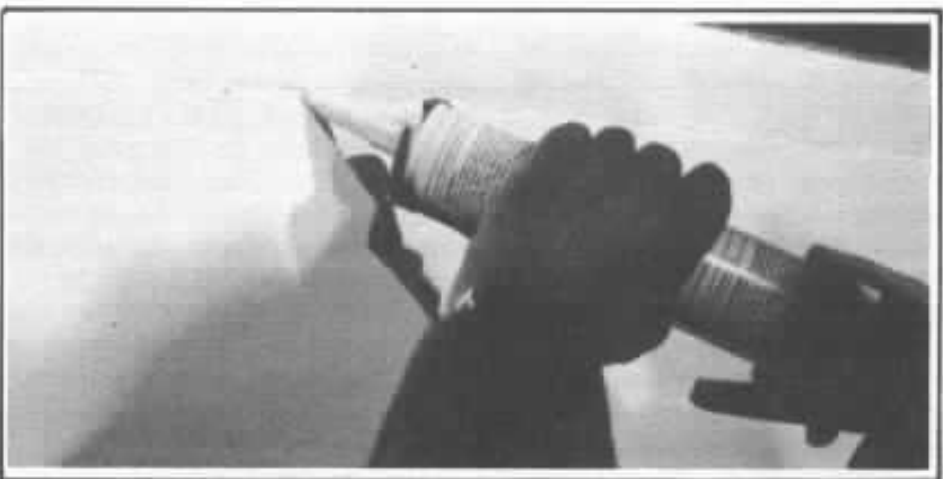
La saignée dans l'enduit au niveau de la semelle est comblée par du mastic afin de préserver le joint élastique.
