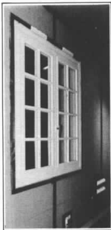
Mise en place des tasseaux sur les murs latéraux pour agraffer le tissu acoustique. Si le travail est précis, la pose est un jeu d'enfant. A remarquer le tableau secteur de l'installation tiré directement du compteur avec filtre secteur incorporé.
