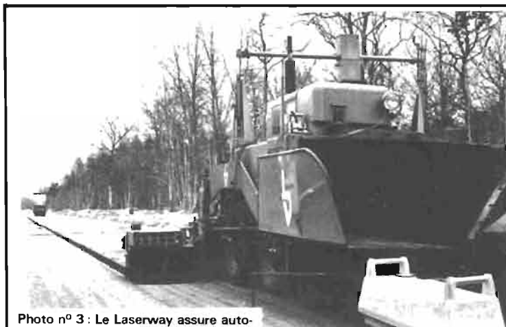
Photo n° 3 : Le Laserway assure automatiquement le guidage en nivellement des engins de travaux publics. On voit, au premier plan, l'émetteur laser ; le récepteur est fixé sur l'engin. Le système est fabriqué par la Cilas et commercialisé par la société française Blaw-Knox.
