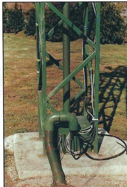
L'ensemble est solidement fixé au sol. Remarquez l'utilisation astucieuse de la tuyauterie PVC et de la gaine électrique.
