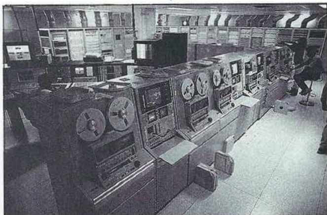
Photo 5 : Salle des magnétoscopes de production.
