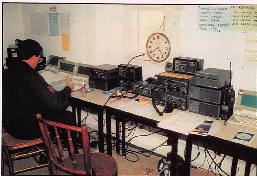
Vue d'ensemble de la station FNRASEC, YOØPCT.
