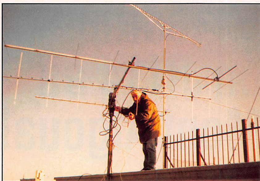
Samedi 14 à 15h30, F6FFQ vérifie l'alimentation du rotor. A l'arrière plan, l'antenne 1255 Mhz
