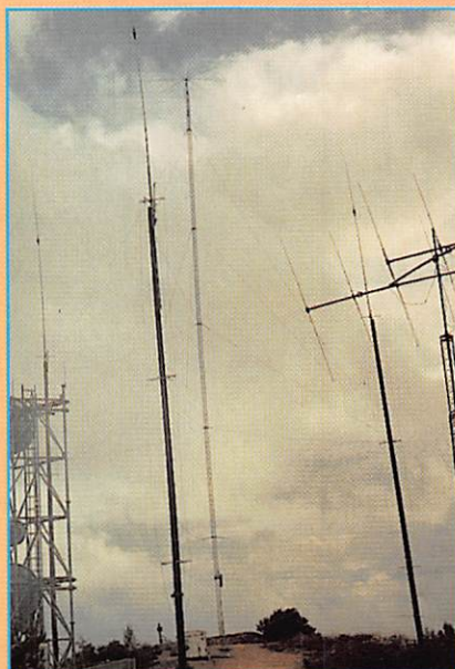
4 él. vertical array pour 160 m.
