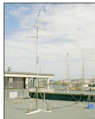
Au Palais du Grand Large : les antennes réception.
