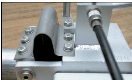
Jonctions mécaniques électriquement soignées.
