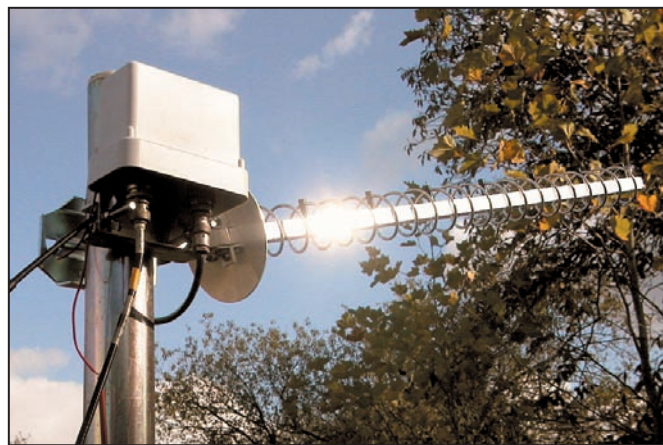
L'antenne n'est qu'à 1,5 m du sol.
