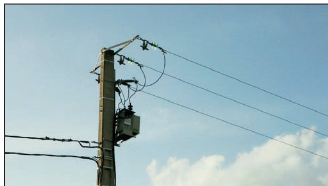
1 - Bientôt un modem à côté du transfo ?
