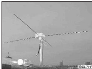
Fig. 6 - Antenne Turnstile (a).
