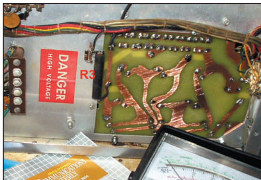
Figure 4: Le nouveau circuit imprimé mis en place.
