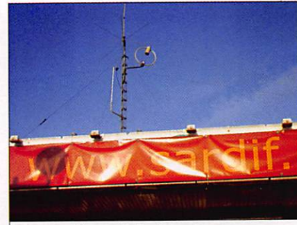
Vue partielle des antennes.
