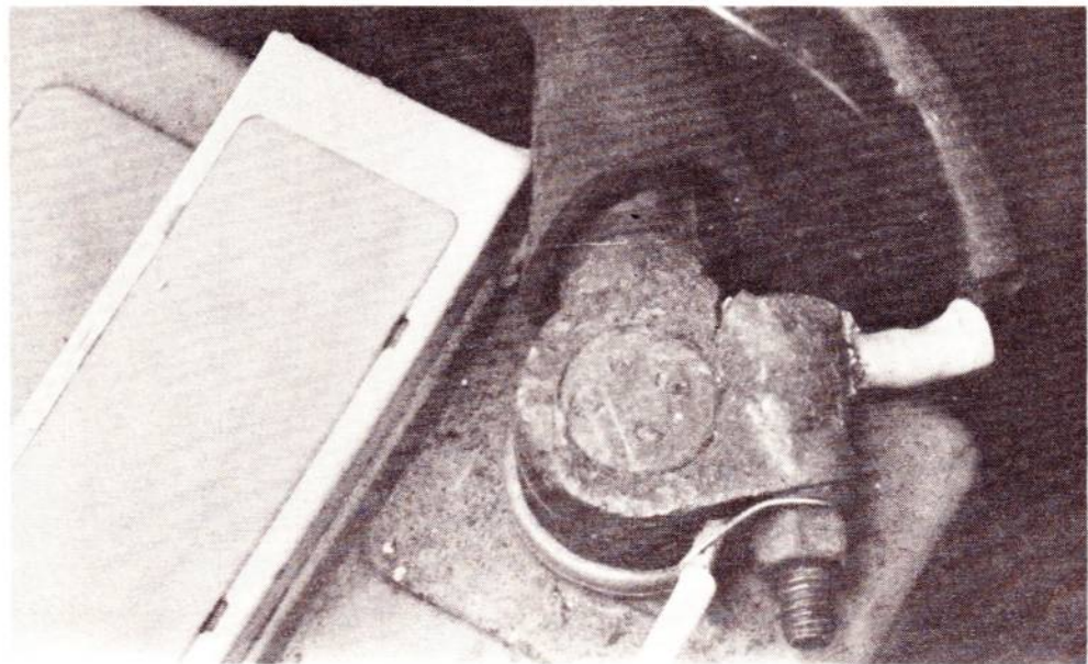
La borne + de la batterie. On reconnaît la ligne de démarreur, le départ vers le circuit général et le fil de mesure qui a été ajouté.
